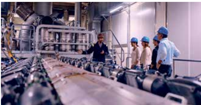
Ein Motor im Gasmotorenkraftwerk GAMOR hat alleine schon 14.200 PS.
