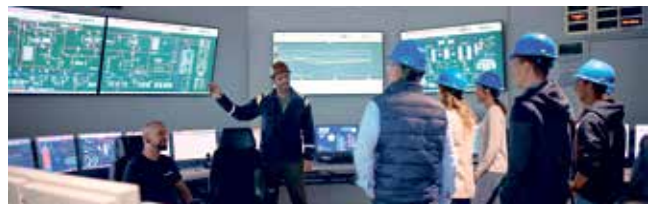
Im Leitstand haben die Kraftwerksmitarbeiter alles im Blick.
