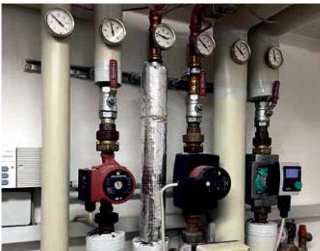
Platzsparend: Fernwärme-Übergabestation im Gebäude der FBO
