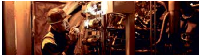
Gasturbine im Heizkraftwerk
